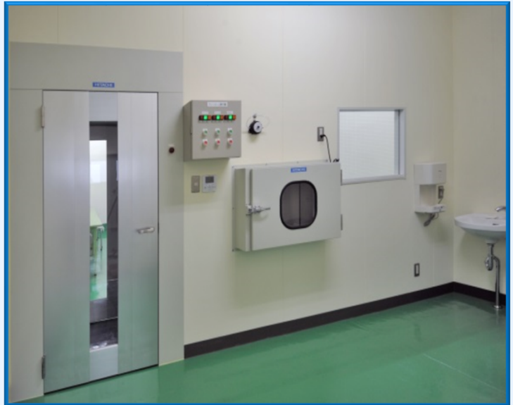
クリーンルーム クラス100,000
